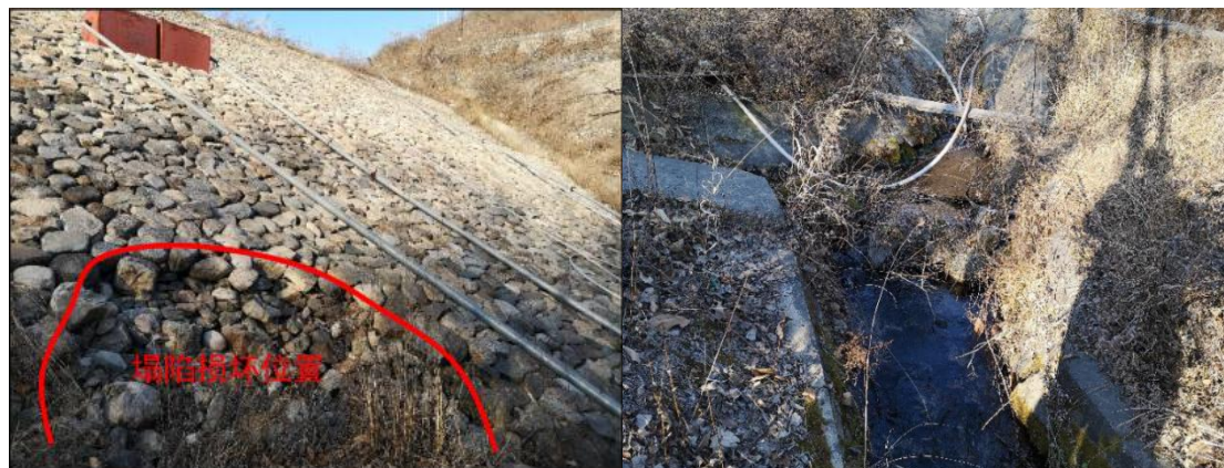
图 2.4-11 初期坝塌陷损坏情况 图 2.4-12 地下水渗出点及排水沟损坏情况
