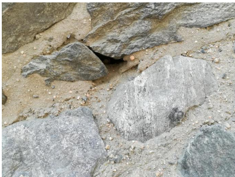
图 2.4-15 北副坝坝面风化剥蚀情况细部图
