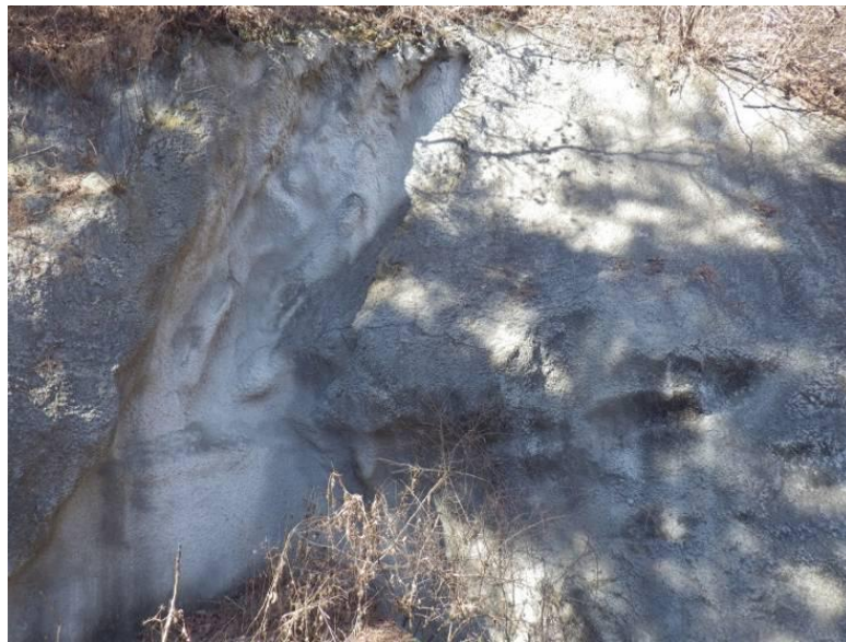
图 2.4-20 隧洞洞口仰坡裂缝
