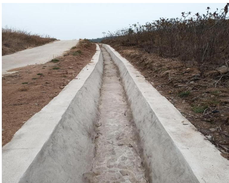
图 2-15 初期坝肩排水沟
